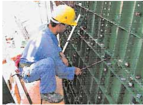
Εικ. 17. Εργασίες σκηροδέτησης τύπου cut and cover. Τελική επένδυση σήραγγας με μεταλλότυπο. Επαναλαμβανόμενη εργασία βιδώματος μπουλονιών. Δε χρησιμοποιείται υδραυλικό κατασβίδι. Πηγή: 19
