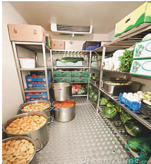
Εικόνα 25: Υγιονομικά ορθή αποθήκευση σε ψυκτικό θάλαμο
