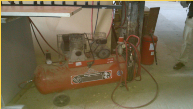
Αεροσυμπιεστής στον χώρο του Ξυλουργείου
